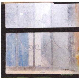
Foto 3: Sustrucción de vidrios. Modulo 1
